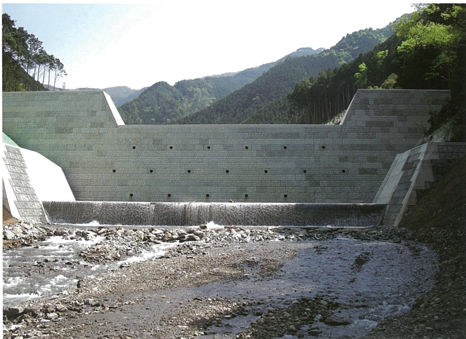
〔宮川水系春日谷川砂防激甚災害対策特別緊急工事〕 三重県・松阪建設事務所
