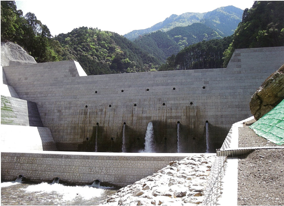
〔宮川水系春日谷川砂防激甚災害対策特別緊急工事〕 三重県・松阪建設事務所
