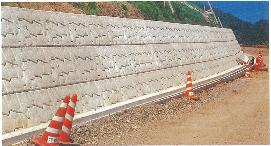
[県道カルスト公園線改良工事]高知県東津野村・高知県土木部
